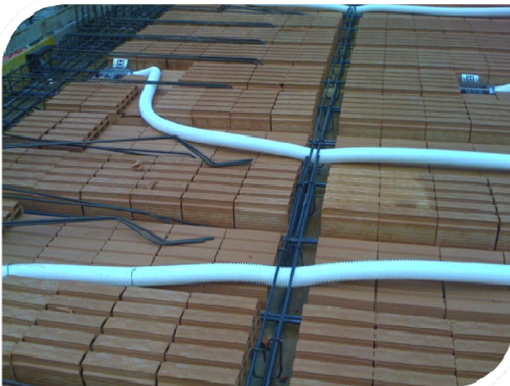
Solaio in latero-cemento con pignatte ribassate: passaggio delle tubazioni nella parte strutturale del solaio e bocchette tutte a soffitto
